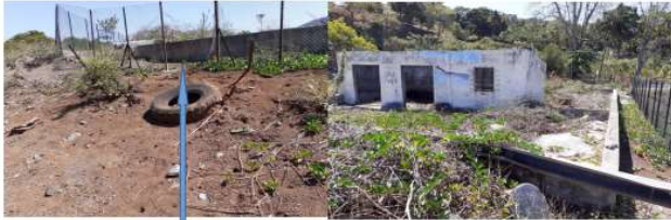
Clôture à réparer
